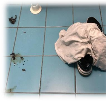
Figure 36 : vestiaire garçons - plastique brûlé
