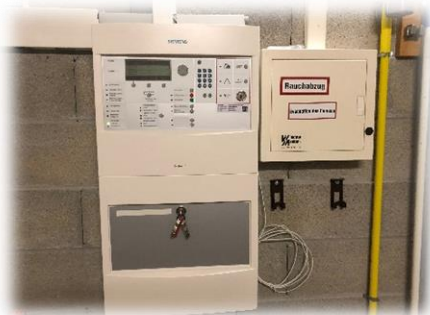
Figure 18 : Nouvelle centrale détection incendie
