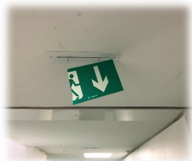
Figure 28 : Panneau de fuite "incendie" cassé
