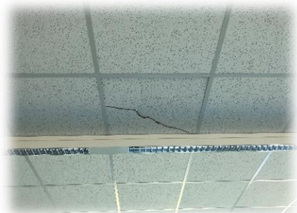
Figure 31 : salle 209 - plafond défoncé
