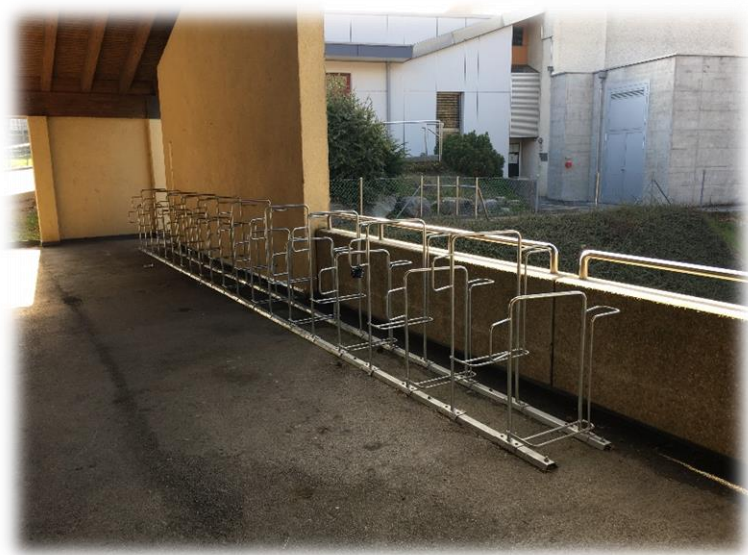
Figure 8 : Parking à vélo - Collège L'Oujon - photo D. ALTHAUS
