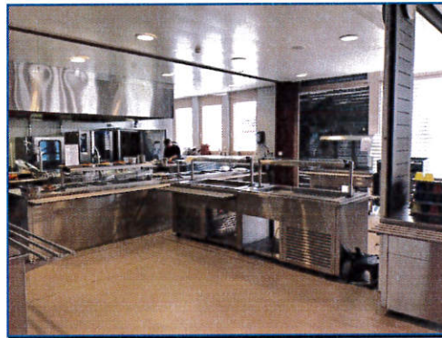
Figure 9 : Cuisine scolaire de la salle Le Gossan
